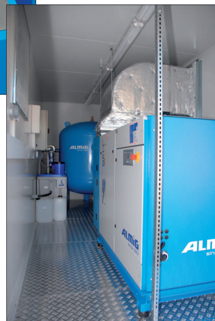
Kontenerowa stacja sprężarek ALMiG Kompresor z separacją kondensatu wodno-olejowego
